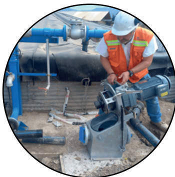
Puesta en marcha de bombas y sistemas
